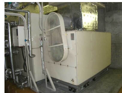
地下書庫系統 空調機
